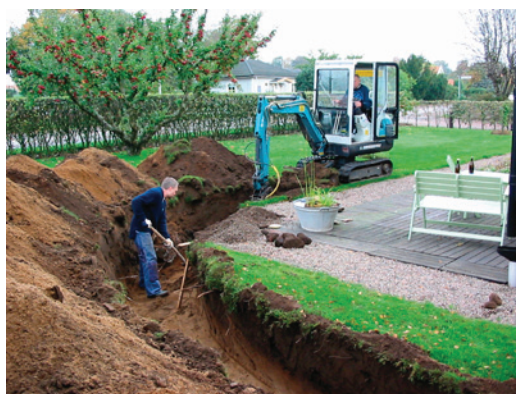
Nordic D-X, 3 kW kräver endast grävning av ett dike på 35 meters längd för nedläggning värmepumpslingorna.
